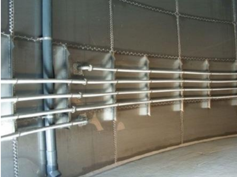
Heizungsrohre an der Wand
